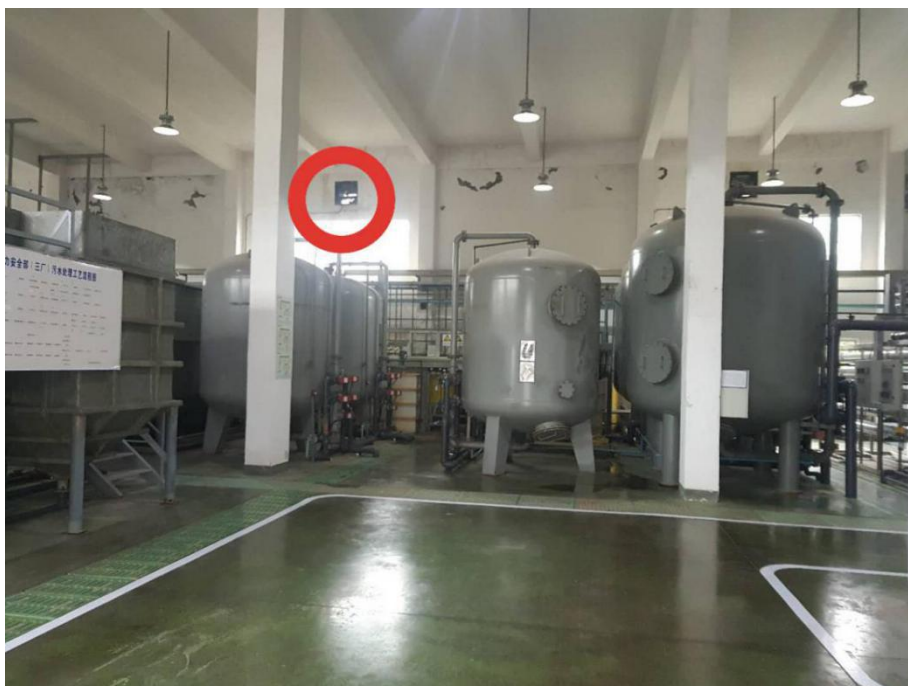
图 2-15 污水站通风设施
